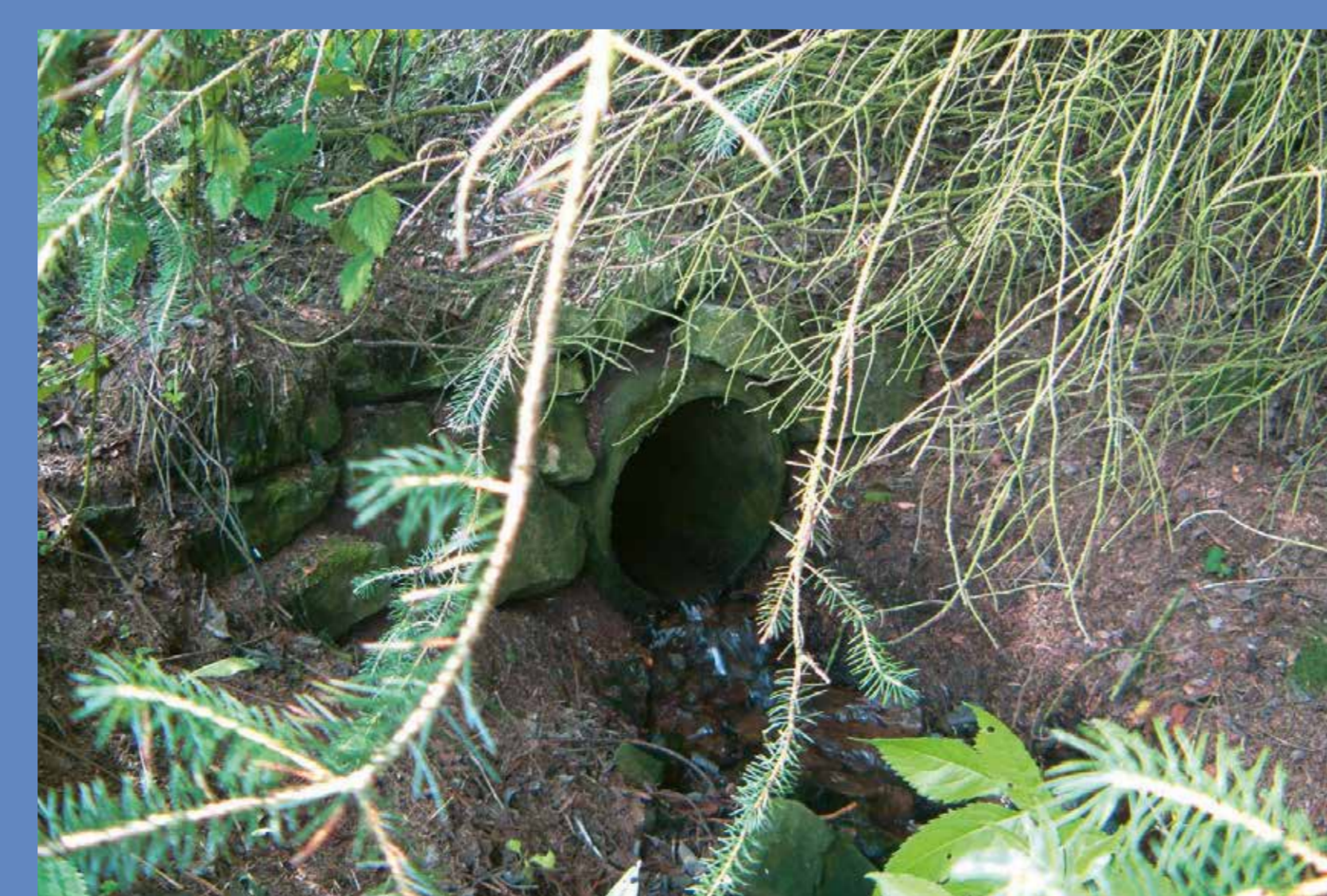
Wanderbarrieren durch Verrohrung
