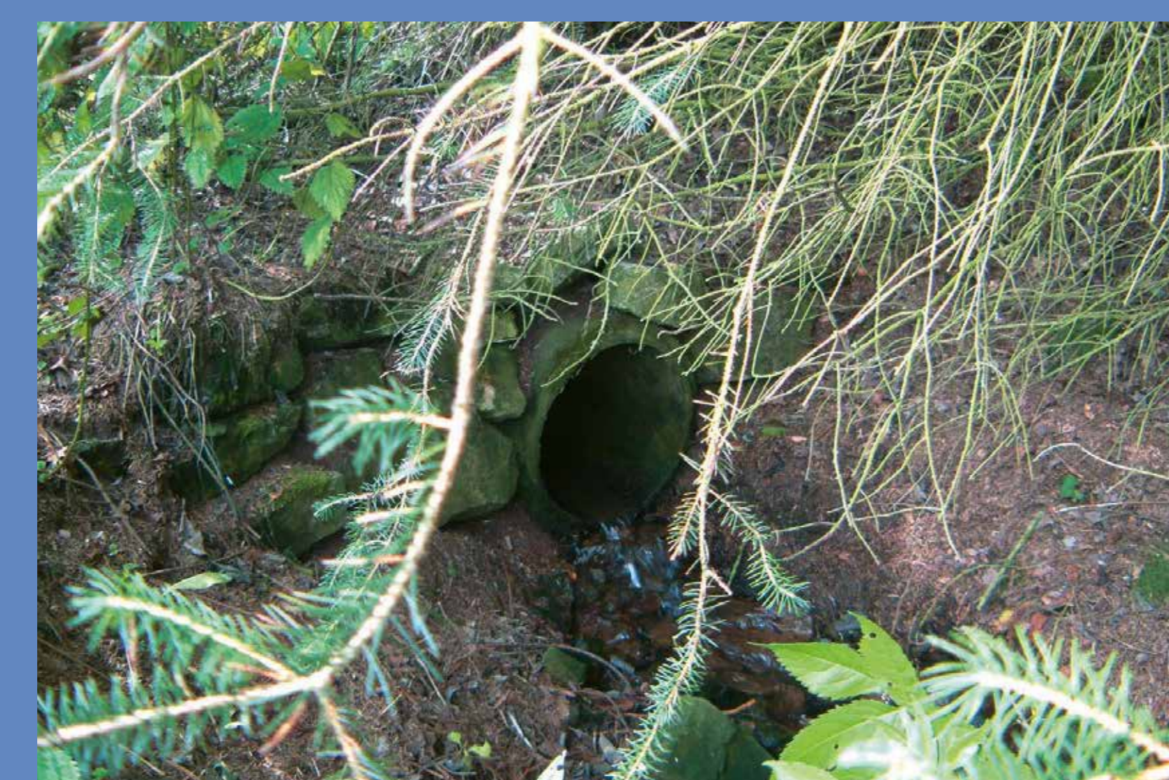
Wanderbarrieren durch Verrohrung
