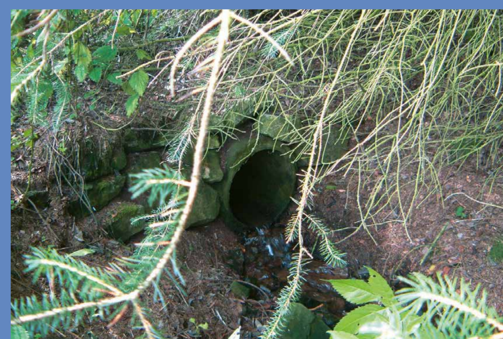
Wanderbarrieren durch Verrohrung
